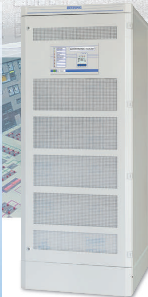
Fig 3: INVERTRONIC modular 90 kVA DC input 220 V
